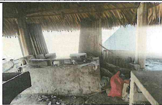
Reparación de estufa rural ya que presenta daños y fisuras en la plancha de concreto
